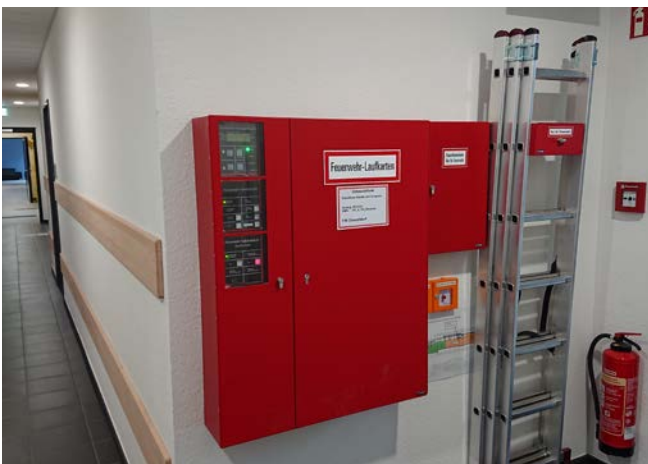
Abb. 6 Notfalleinrichtungen für die Feuerwehr
