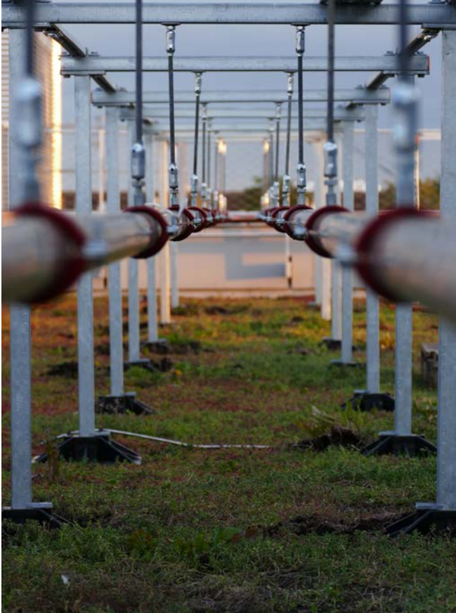
Abb. 14 Versuchsanlage auf dem Dach eines Hochschulgebäudes
